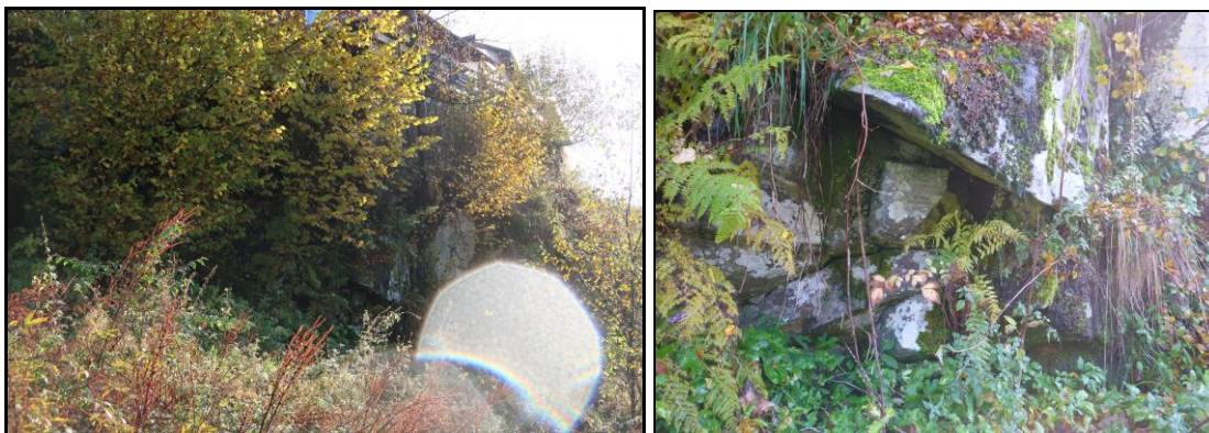
Figur 9. Bergskrent under Osterøyvegen 23 med store avløste blokker og åpne sprekker.
