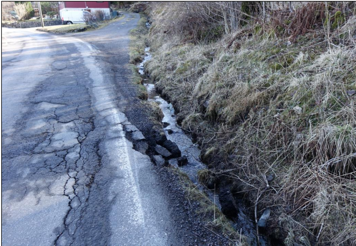
Figur 17: Deler av asfalt inn mot skjæring er vasket ut. Rødt hus i bakgrunnen har gnr/bnr 96/24.
