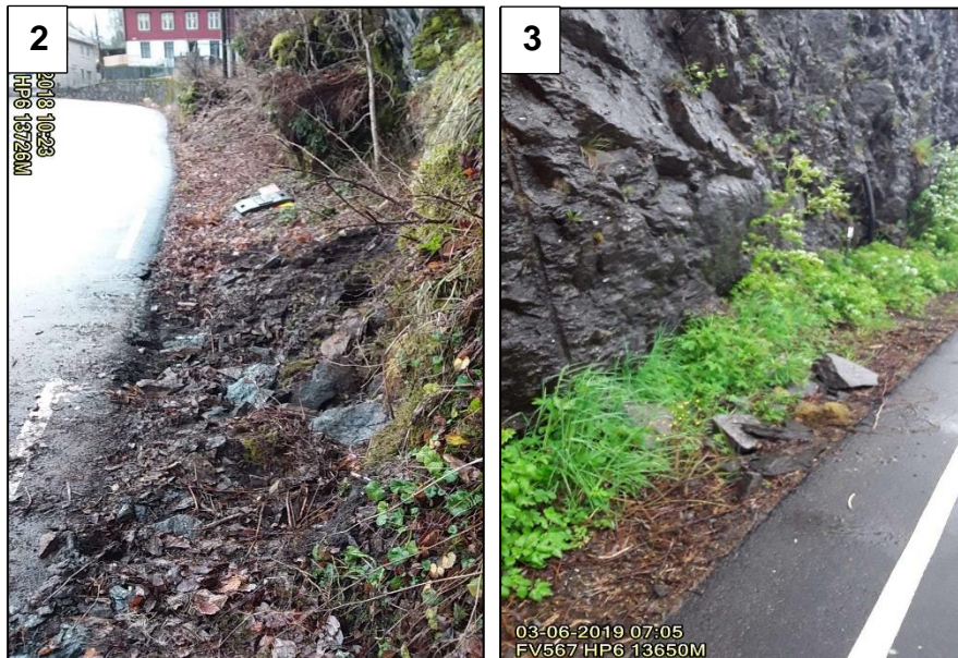
Figur 14: Steinspranghendelser utenfor planområdet, langs fylkesvegen. Bilder fra Statens vegvesen.
