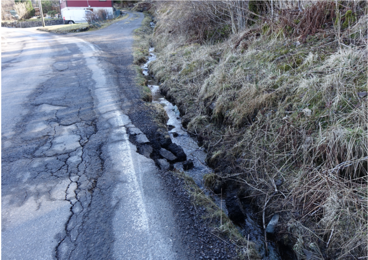
Figur 12: Deler av asfalt inn mot skjæring er vasket ut. Rødt hus har gnr/bnr 96/24.
