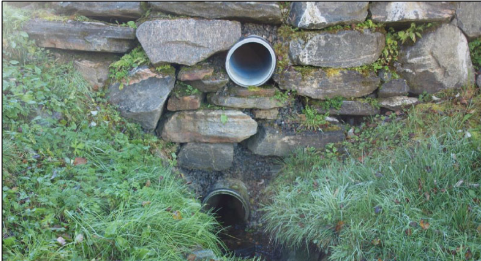
Figur 34: Dreneringsrør fra mindre bekk til Holeelva (foto: Geolog AS, 2016)
